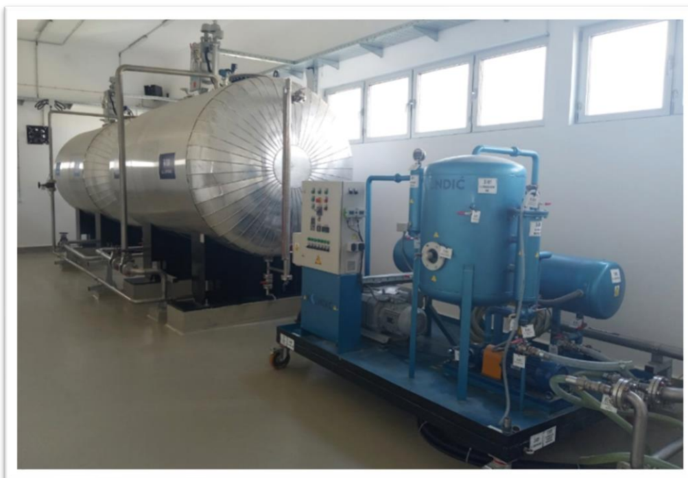
Slika 3: Prikaz unutrašnjeg dela pogonske zgrade sa tehnološkom linijom CUG
